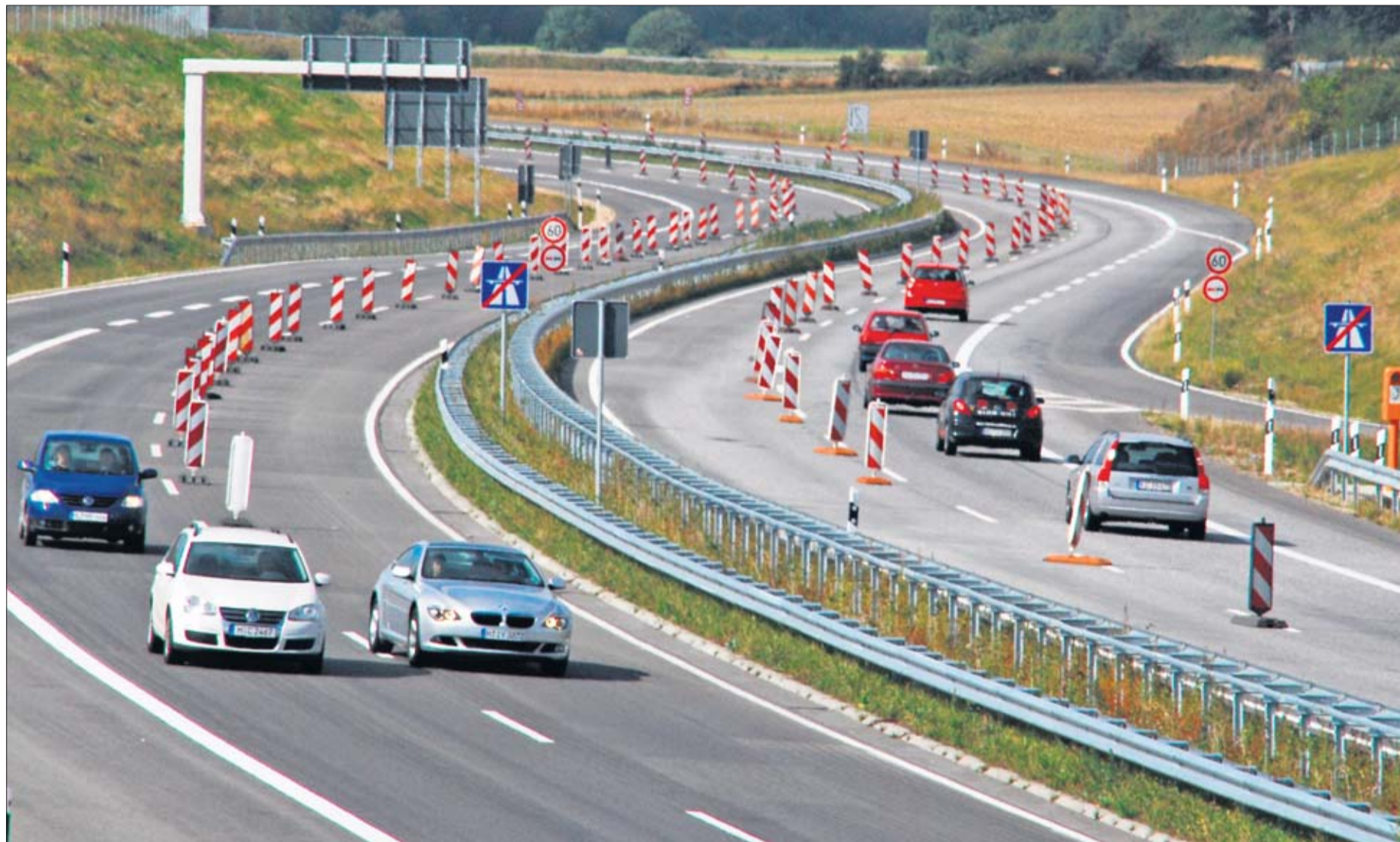
Letzte Abfahrt Geschendorf: Hier trifft die A 20 auf die Bundesstraße 206. Westlich der Anschlussstelle rollt der Verkehr an der Autobahn-Baustelle vorbei. FOTO: KLITZ
